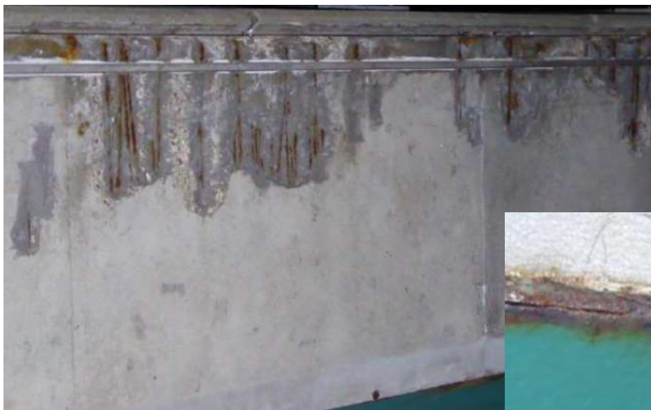
Armatures apparentes corrodées
