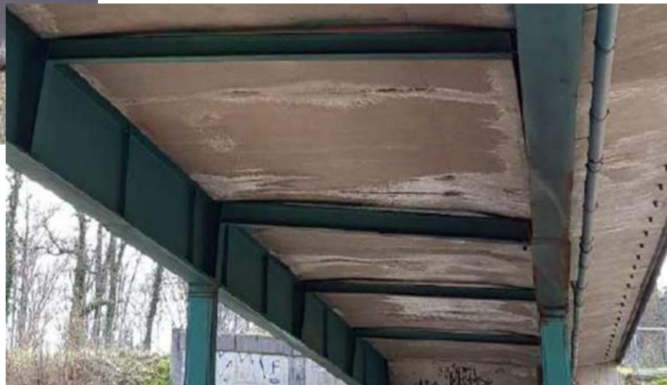
Taches d'humidité – armatures apparentes
