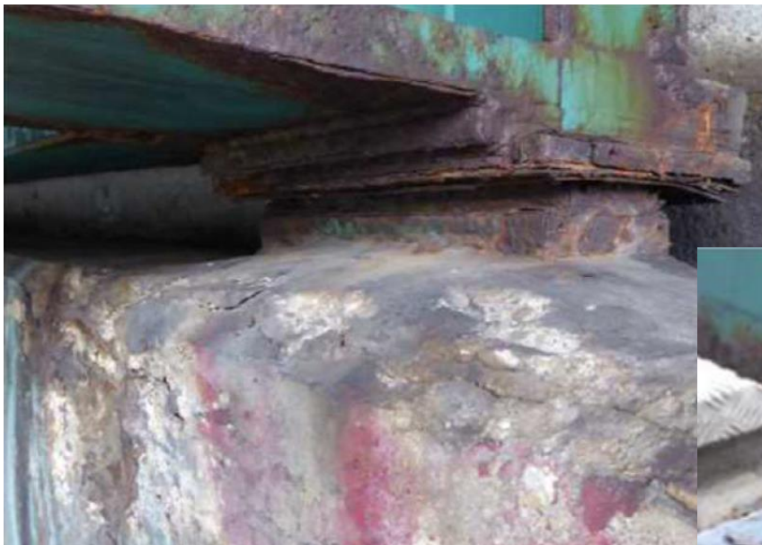
Dégradation appareils d'appui et culées
