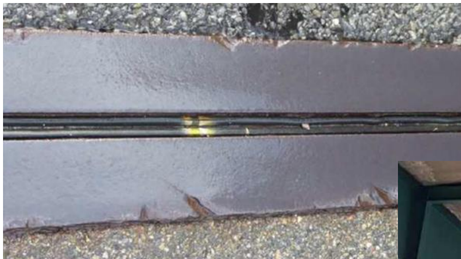
Joints de chaussée abimés
