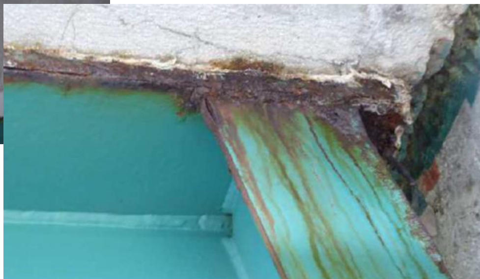
Interface acier-béton corrodée
