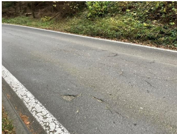
Arrachement et fissuration
