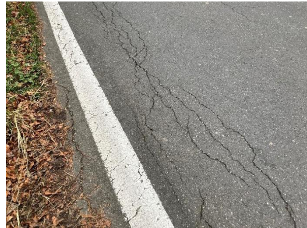
Affaissement de rive
