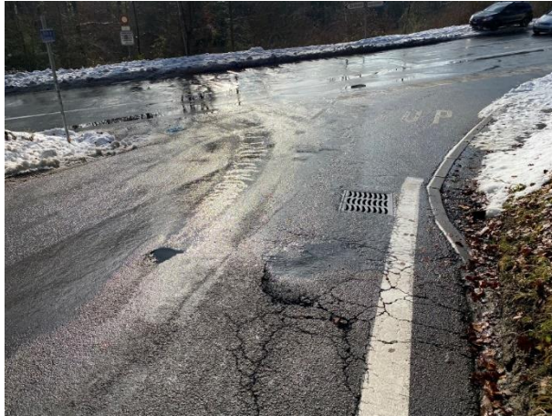
Résurgence d'eau et faïençage
