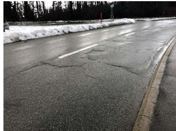
Fissuration transversale et longitudinale
